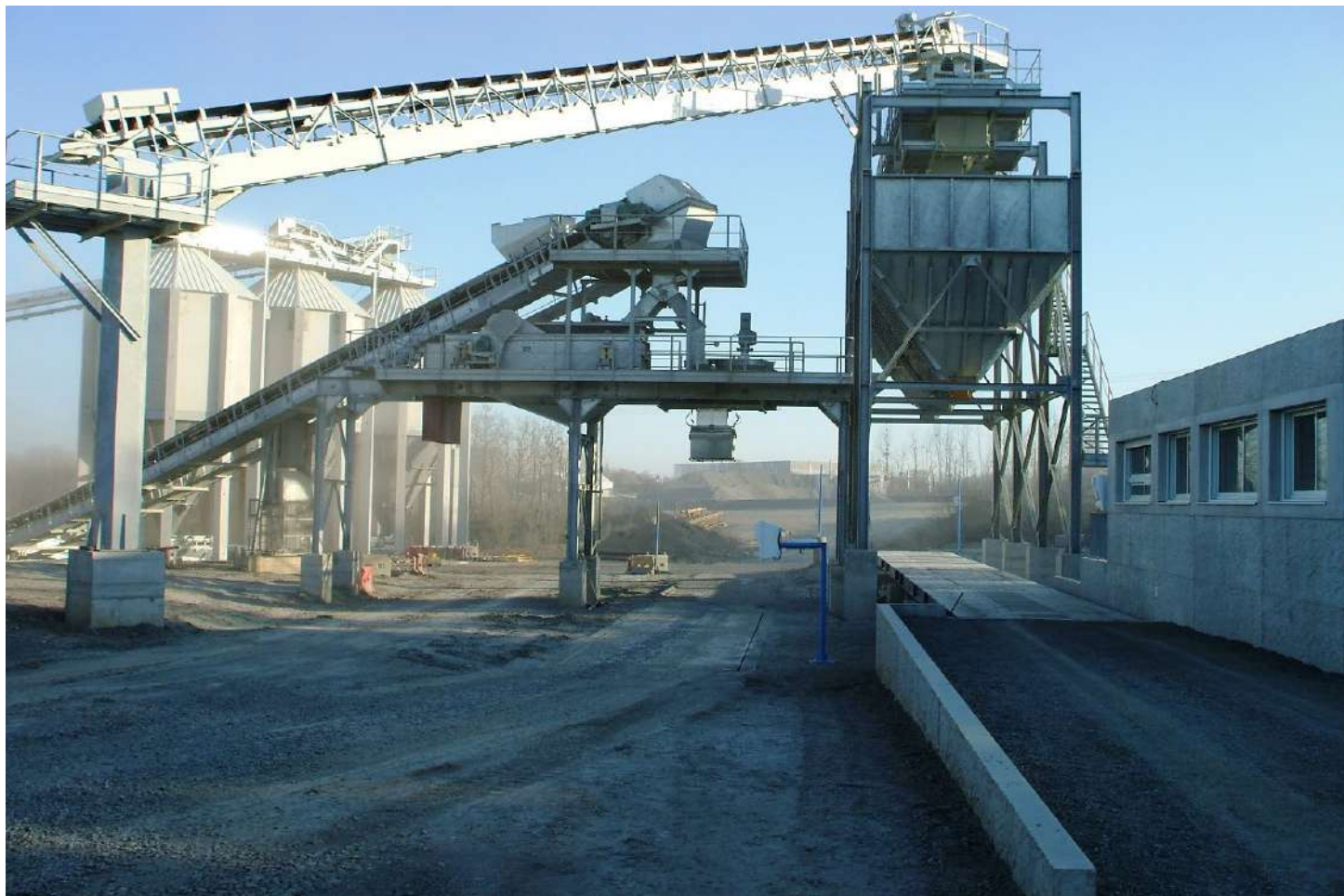
PESAJE DEBAJO DEL TANQUE Y CONTROL DE ACCESO
